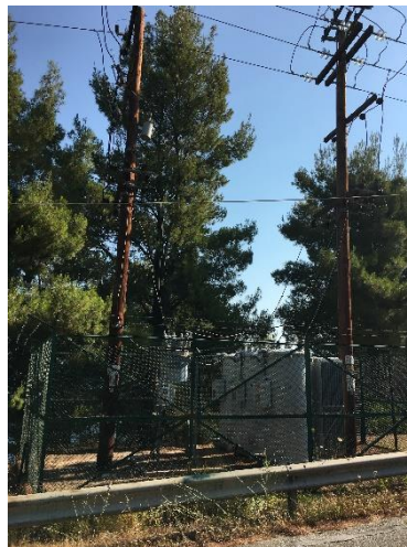
SLIKA 3 - Primer povezivanja tri jednofazna regulatora na tlu (Grčka)
